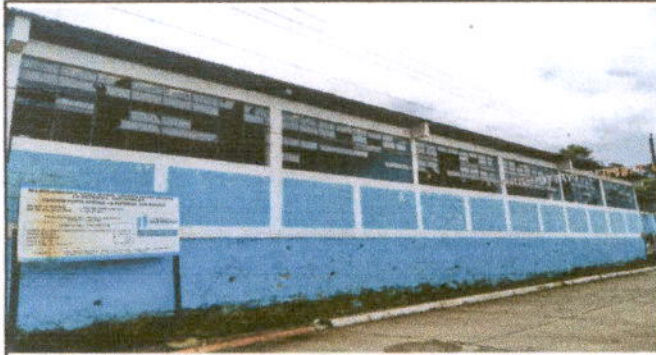
Foto1: MÓDULO 1 AULAS VENTANAS: Sustitución de estructura de metal de ventana, Mantenimiento a balcones de metal
